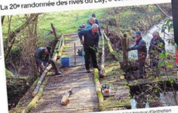
Les adhérents des Galoches réaumuroises ont effectué les travaux d'entretien des chemins. (Photo : Galoches réaumuroises)
